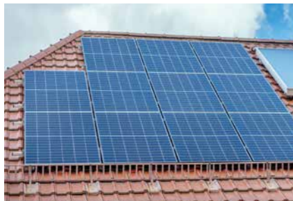
Solaranlage einheitlich auf Dach angebracht
