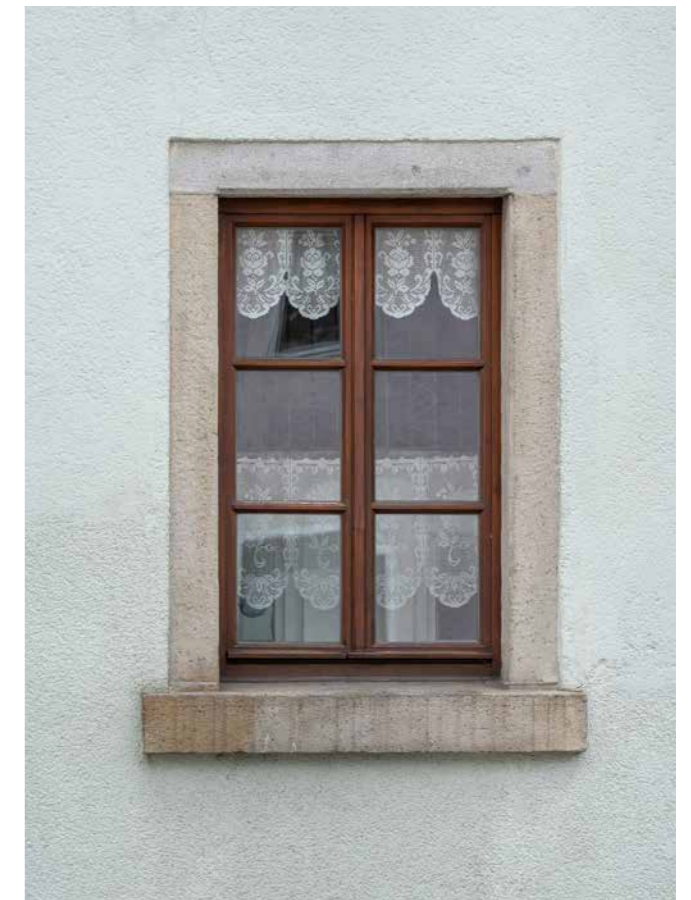
Vermittlung zwischen historischer Fenstergliederung und den heutigen Anforderungen an den Wärme- und Schallschutz
