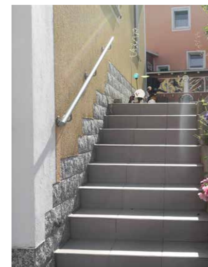
Handlauf aus Stahlrohr als Treppensicherung
